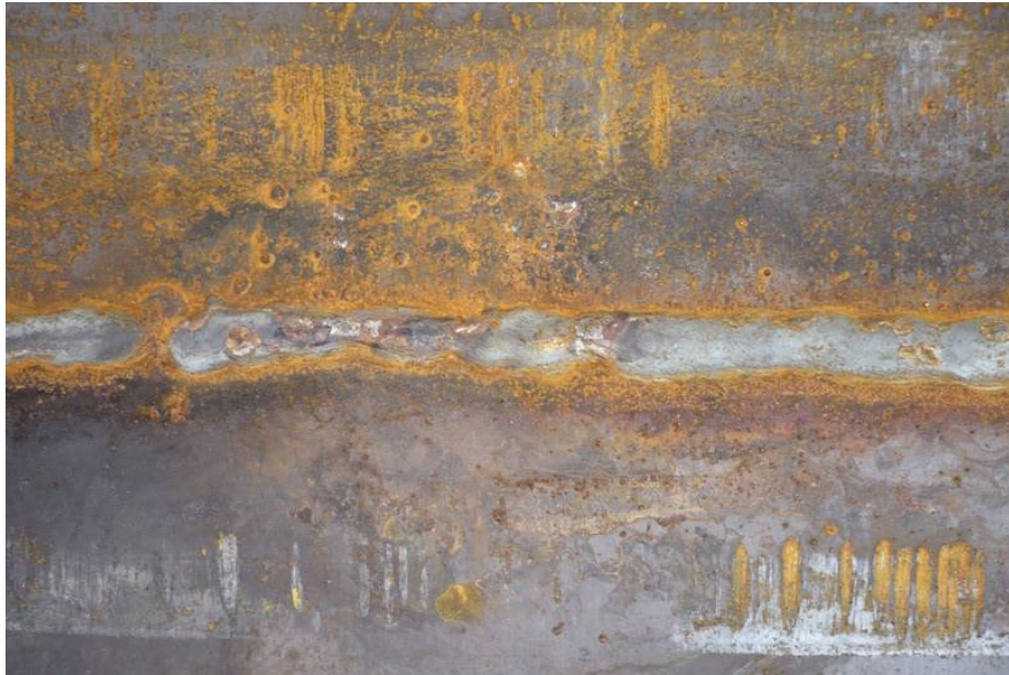
Figura 25 – Falta de fusão em parte do cordão de solda
