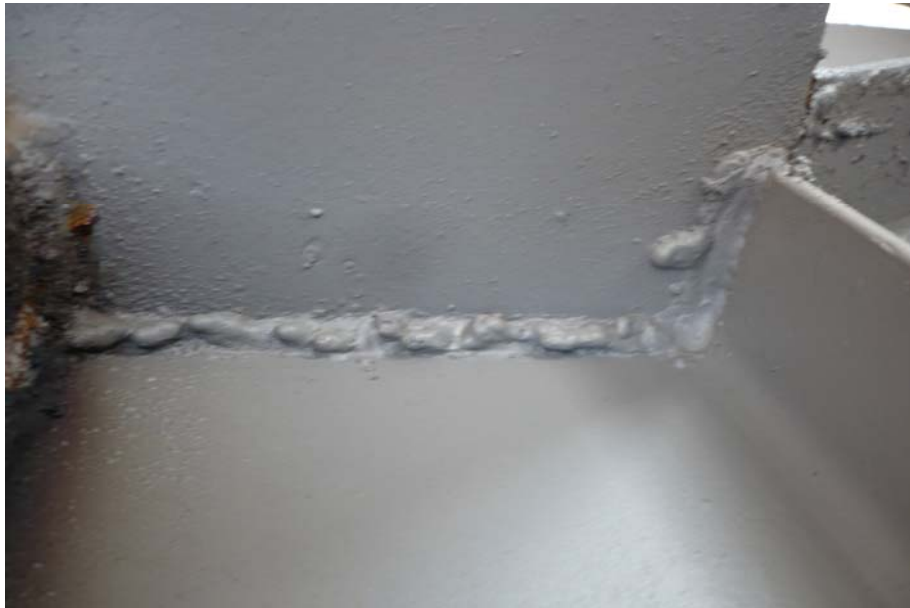
Figura 27 – Falta de Fusão em parte do cordão de solda
