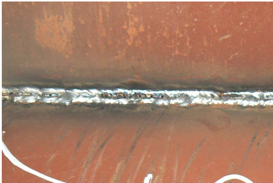
Figura 41 – Porosidade em junta soldada
