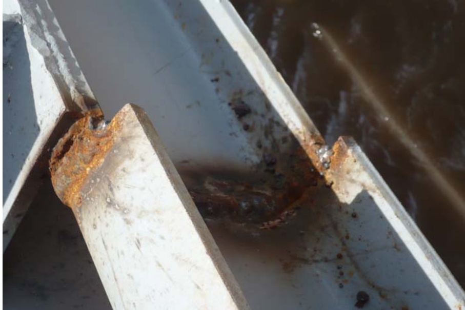
Figura 22 – Verificação em campo de juntas incorretas
