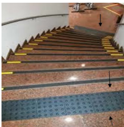
Figura 7: Sinalização tátil de alerta no início e no final da escada, contrastante com o piso.
